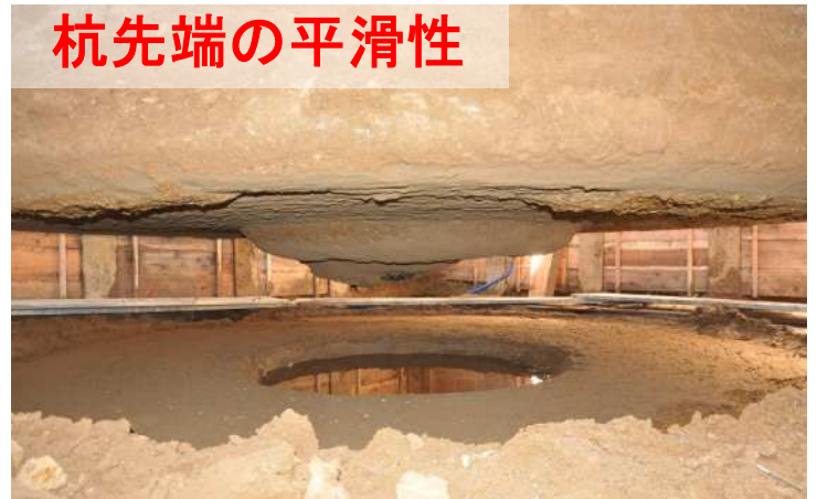
掘出し後の杭先端状況 φ5500
