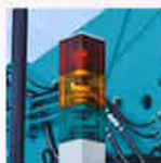
●過負荷外部表示灯
